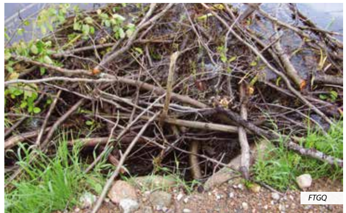
Ponceau colmaté par un castor
